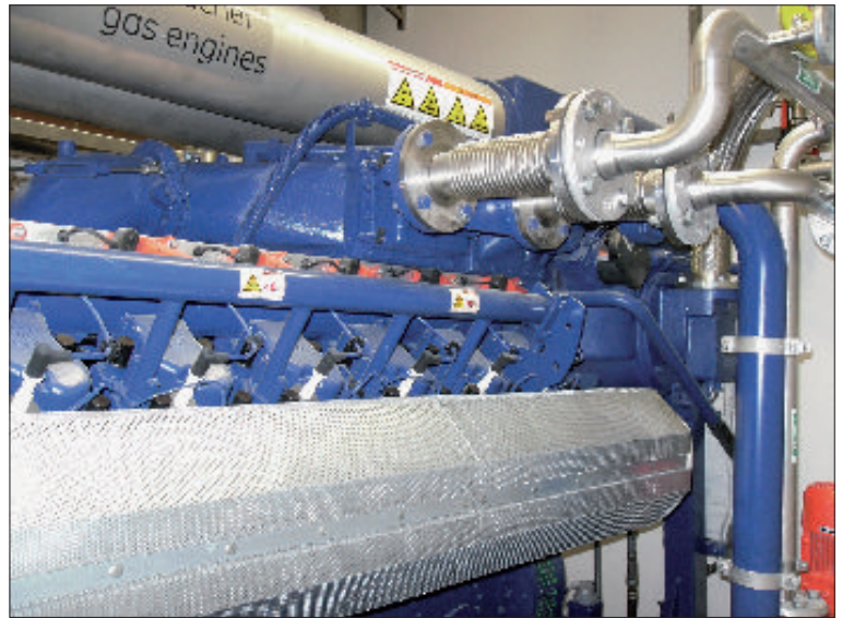
Abb. 6: Blick auf den Gasmotor
