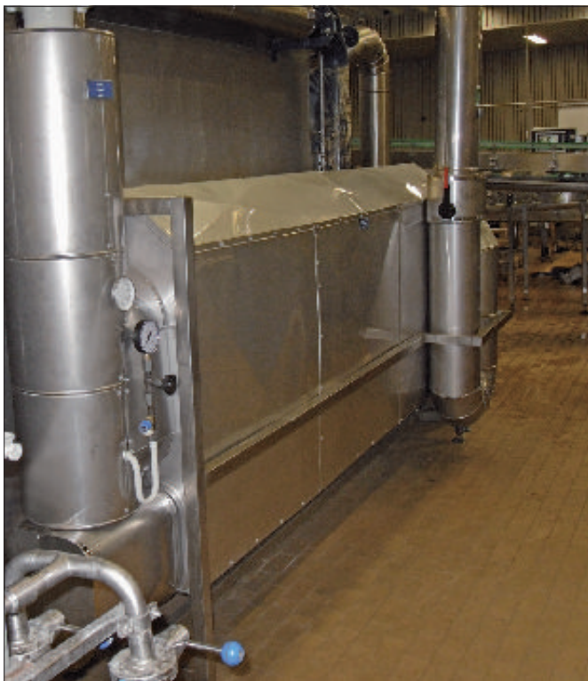
Abb. 3: Spezialwärmeübertrager zur Laugenbeheizung an der Flaschenreinigungsmaschine
