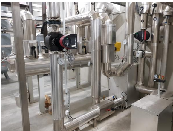
Teilbereich der Energieversorgungsanlage
