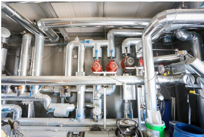
Foto: Schloßgut Kühbach / Fernwärme
